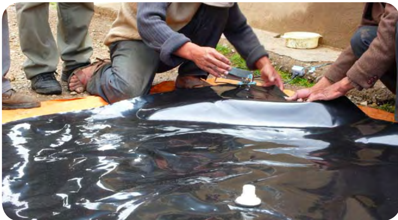
Figura 29: El reservorio se construye con 3 metros de polietileno tubular. Tras poner un pasamuros (o flange) en el centro, se sellan los extremos del plástico con una selladora manual.
