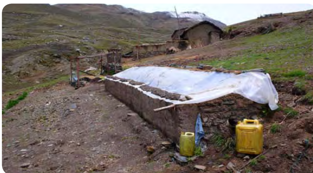
Figura 1: Biodigestor familiar de bajo costo instalado en Pakuani (La Paz, Bolivia) a 4.221 metros sobre el nivel del mar. Este biodigestor produce biogás suficiente para cocinar 4-5 horas al día, alimentándolo con 20 kg de estiércol fresco y 60 litros de agua diariamente. Produce además 80 litros de fertilizante al día. Como curiosidad, este es el biodigestor más alto del mundo funcionando.
