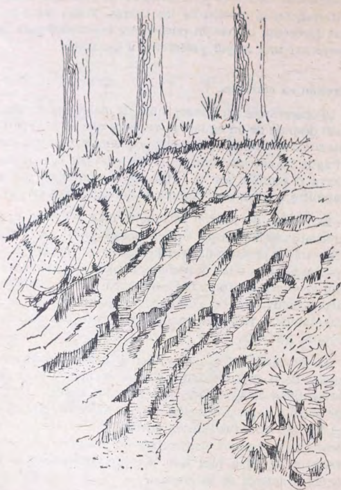
Figura 10. Suelo con erosión en cárcavas.
